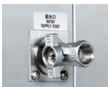
純水供給口 (減圧弁付)
